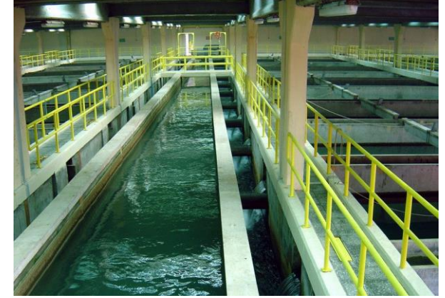
Ankara İvedik Şehir İçme Suyu Arıtma Tesisi (Ankara)
