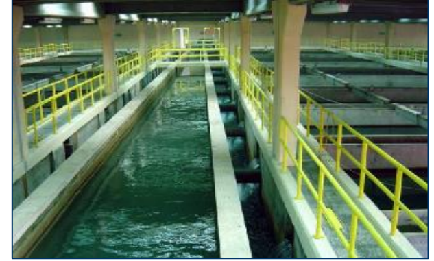
Ankara İvedik Şehir İçme Suyu Arıtma Tesisi (Ankara)
